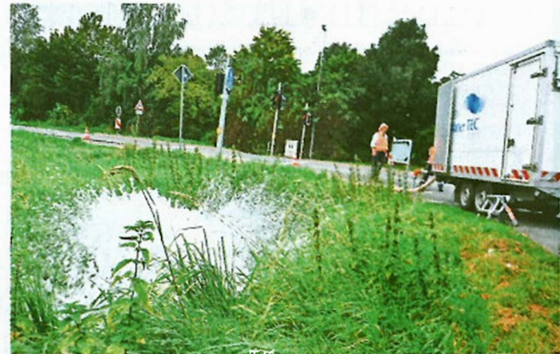
Wie ein Springbrunnen: Eine Spezialfirma unterstützt die ÜWL in dieser Woche beim Reinigen des Rohrnetzes in der Region.
