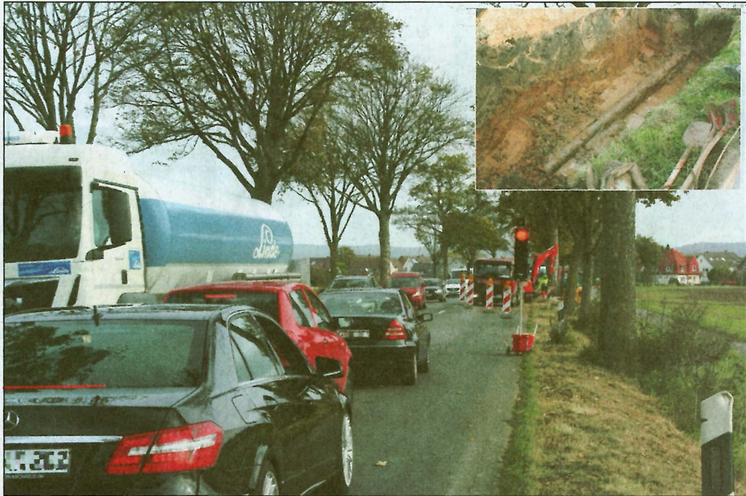
Langer Stau an der Baustellenampel: Ein Rohrbruch der Wasserleitung zwischen Gronau und Eime und kurze Ampelzeiten führen zum „Verkehrschao“ in Richtung Gronau. ■ Fotos: Appel
